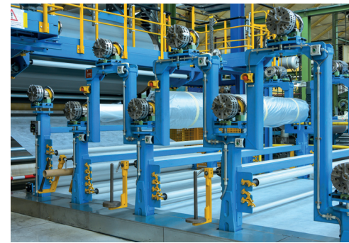
DIE NEUE VULKANISIERUNGSANLAGE ROTOCURE D320 IST SEIT ACHT WOCHEN IN BETRIEB UND ERMÖGLICHT EINE PLATTENBREITE VON 3,20 METER. (FOTOS: STEINBACH AG)
